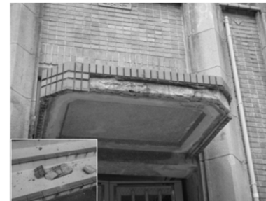
▲外壁タイルの剥落
