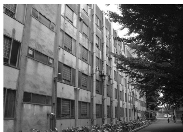
▲老朽施設の外観（経年48年）
