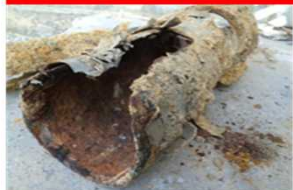
■排水管 経年36年 劣化により腐食、破損し、排水が漏洩。
