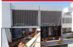
■空調機 経年23年 内部部品が腐食したため、温度調節ができない状態。
