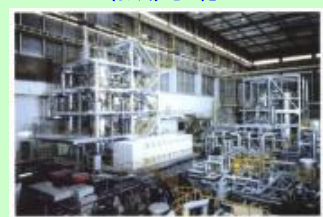
大型構造機器実証試験ループ (HENDEL)
