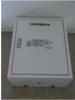
特設公衆電話取付端子 (東京都北区立十条富士見中学校) ※電話は備蓄倉庫等に保管して おき、避難所開設時に使用。
