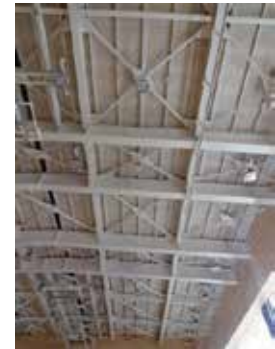
省エネのために設置した屋内運動場のLED照明 (東京都北区立十条富士見中学校)
