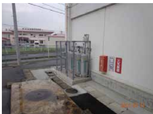
震災時にも炊き出しに利用した LP ガスのタンク (宮城県立石巻支援学校)
