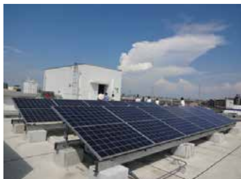
自立運転可能な太陽光発電システム (東京都江戸川区立松江小学校)
