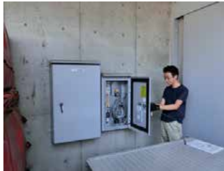
屋内運動場で電気を使えるようにするための可搬式発電機取付口 (東京都北区立十条富士見中学校)
