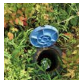
屋上のプールからマンホールトイレに 水を流すために設けたバルブ (東京都北区立十条富士見中学校)
