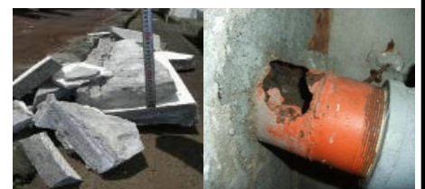
(左)落下したモルタル (右)劣化による配管破損
