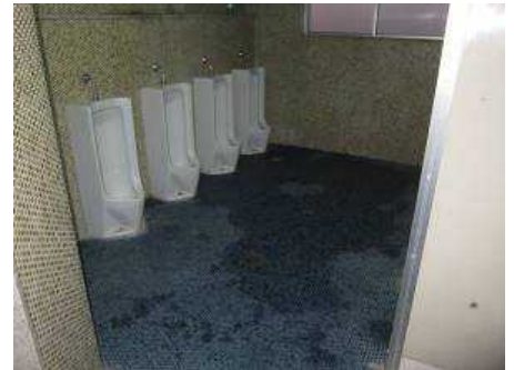
トイレの老朽化による臭気の発生
