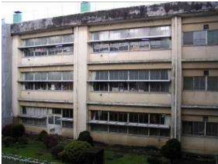
外装材の著しい劣化
