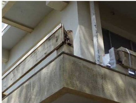
老朽化による手すりの落下
