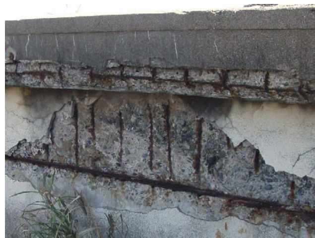
写真3 塩害による鉄筋の腐食
