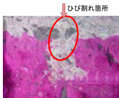
図2 ひび割れ周囲のコンクリートの中性化（赤紫色：アルカリ性，無色：中性）
