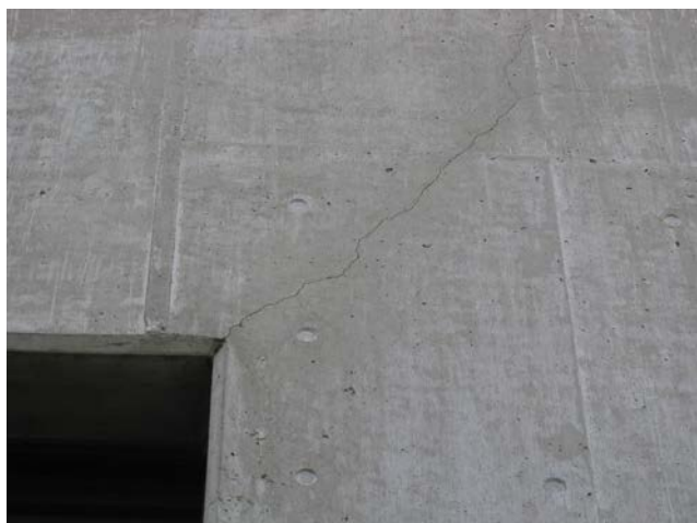
写真1 コンクリートの乾燥収縮ひび割れ
