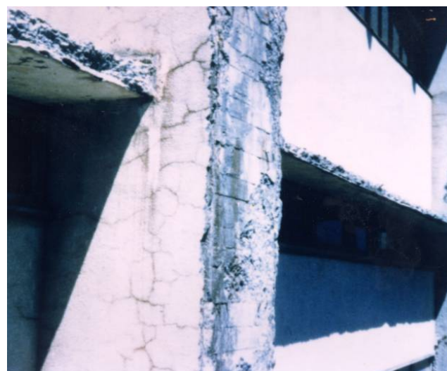
写真4 凍害によるはく離・ひび割れ
