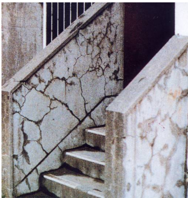
写真5 アルカリシリカ反応によるひび割れ
