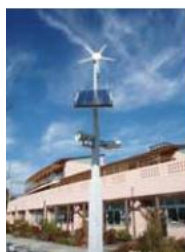
風力発電装置を設置 〔山梨県昭和町立押原小学校〕
