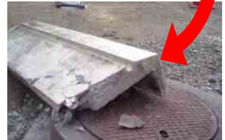
老朽化による手すりの落下
