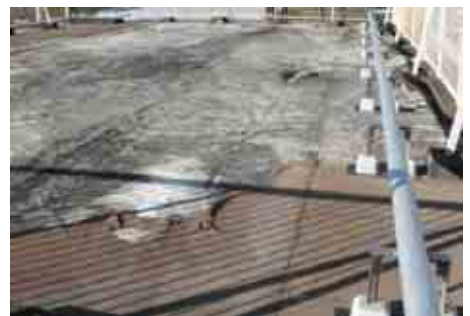
屋上防水の劣化により頻発する雨漏り
