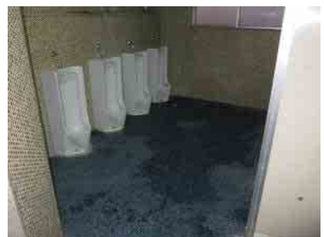
トイレの老朽化による臭気
