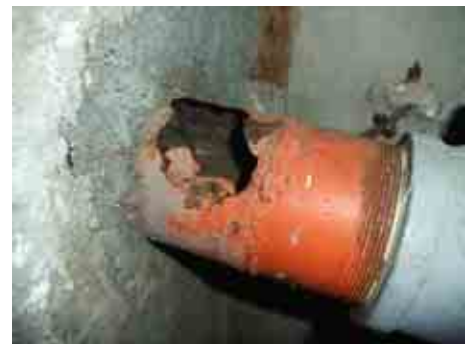
劣化による配管の破損
