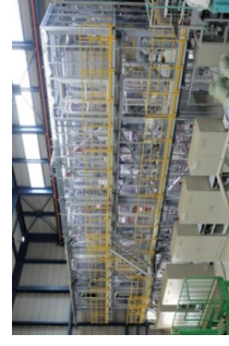
連続水素製造試験装置
