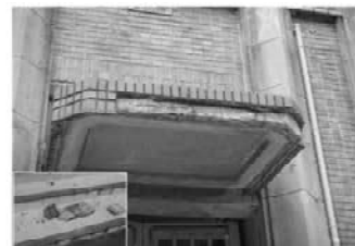
▲外壁タイルの剥落
