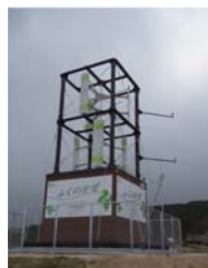
福島大学がコンソーシアムと開発した縦型5kW風力発電システム実証機
