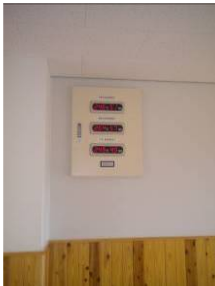
室内外の温度表示板
