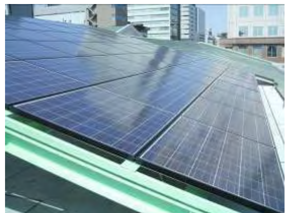
桜木小学校太陽光発電設備設置状況
