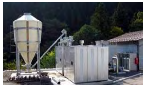
中学校寮のペレットボイラー施設
