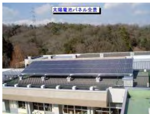
俵口小学校太陽電池パネル
