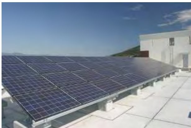
屋上階の太陽光発電設備。
