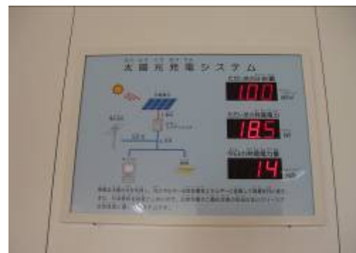
○発電量表示パネル
