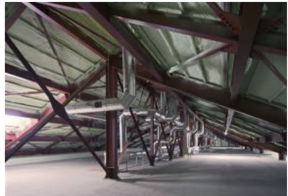
温められた空気を室内に送る屋根裏の配管
