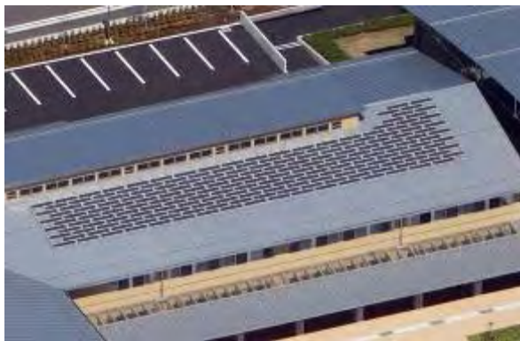
(校舎棟屋根に設置した太陽光モジュール)
