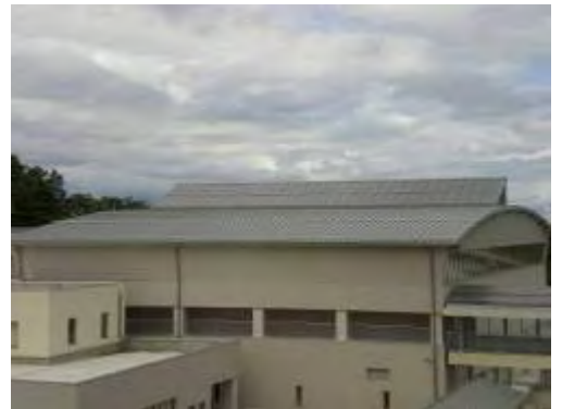
空気集熱式パッシブソーラーの集熱パネル（屋体）
