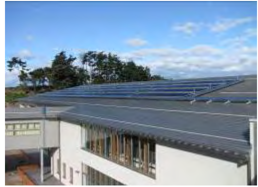
ソーラー熱真空温水集熱パネル（校舎）
