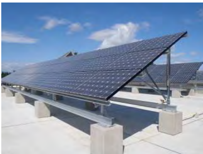
校舎屋上に設置した太陽光発電設備
