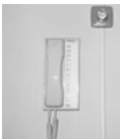
【非常ベル（保育室設置）】
