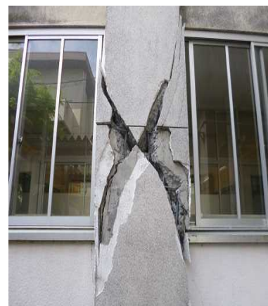
柱のせん断破壊
