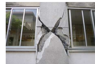
耐震化未完了の建物に甚大な被害
