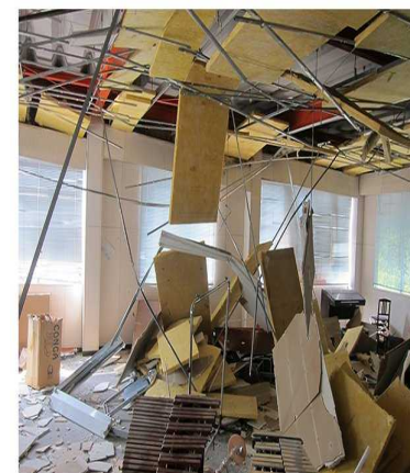
天井材の落下
