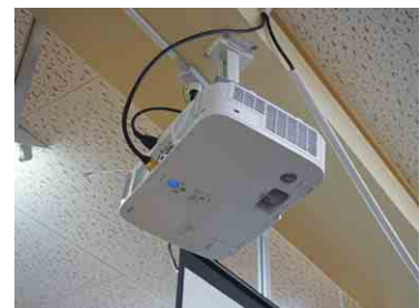
▲ 프로젝タを天井固定式にすると授業開始前の設置・調整作業が省略できる
