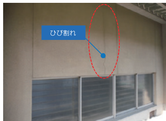
外壁のひび割れ
