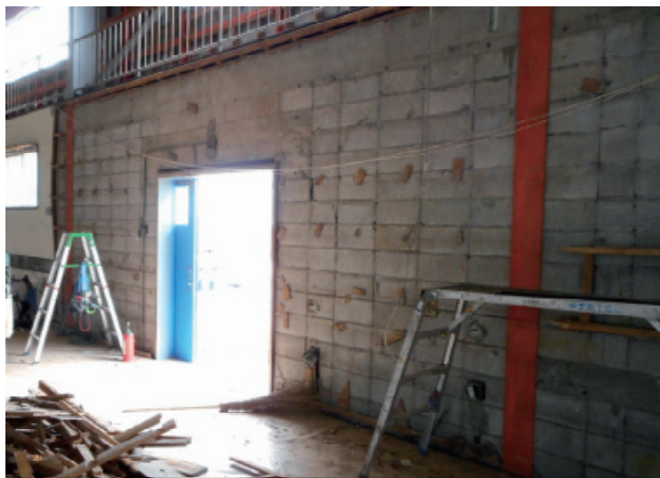
コンクリートブロックを使用している強度に問題のある壁
