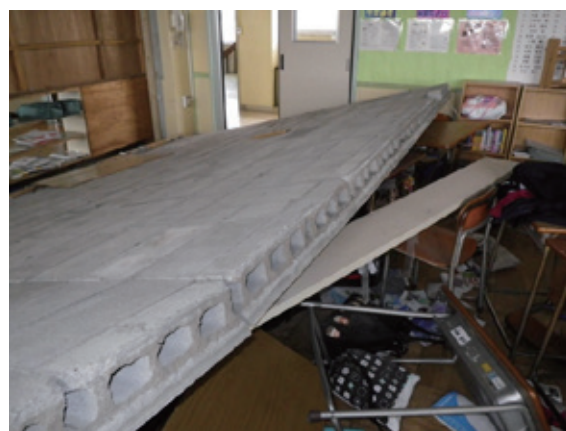
コンクリートブロック壁の全面倒壊 (RC 造架構との境界部分)
