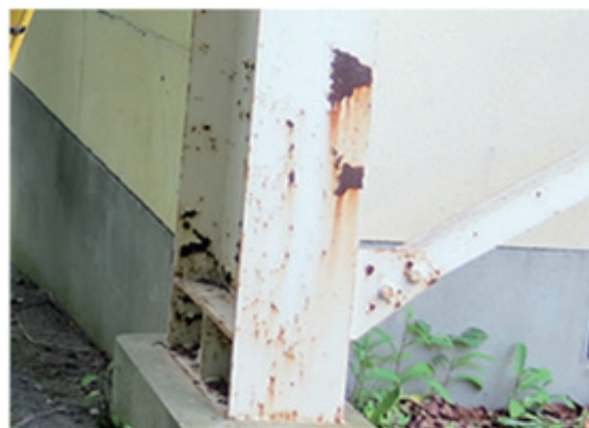
鉄骨部の錆及び塗装の剥がれ
