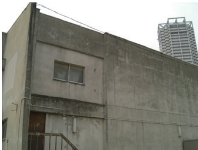
経年劣化のため、汚れている外壁
