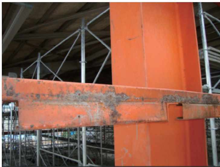
鉄骨の劣化状況
