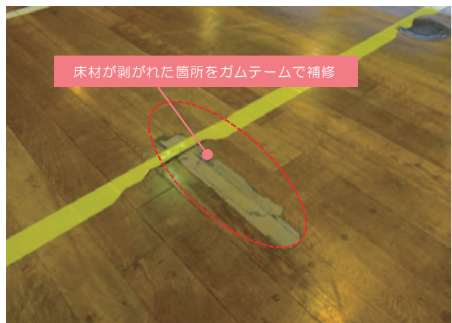
老朽化したアリーナ床面
