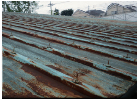
老朽化した屋根
