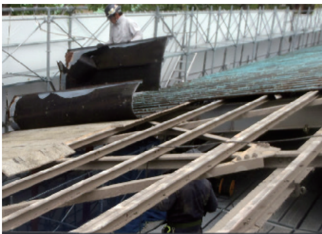
屋根部材の劣化状況
