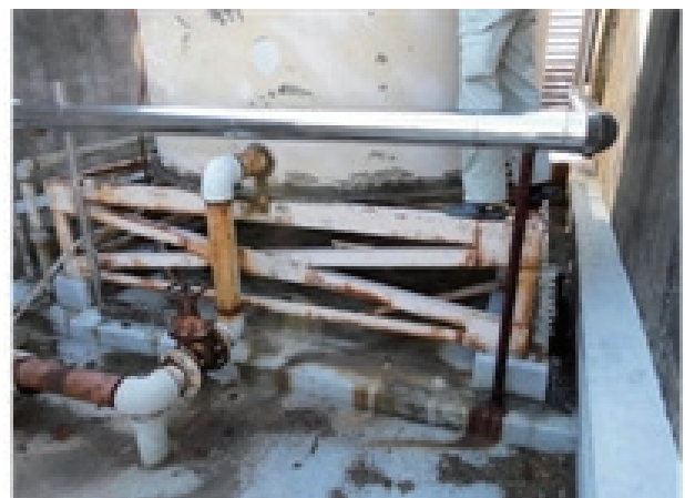
金属錆がある老朽化した給排水設備
