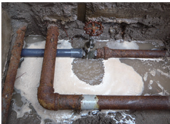
劣化が著しい配管
