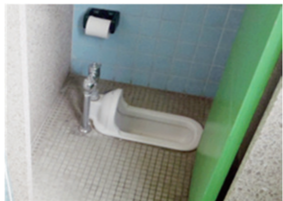
老朽化したトイレ
