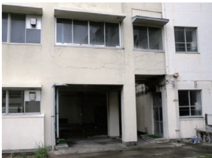
ひび割れや欠損が見られる外壁
