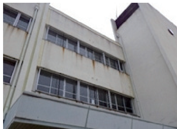
塗膜の剥離、軽微なひび割れ、金属錆が見られる外壁
