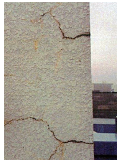
外壁表面のひび割れ（錆汁発生）
