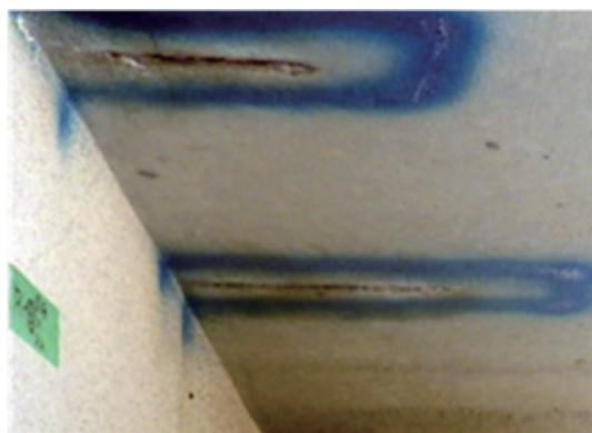
軒裏の鉄筋露出
