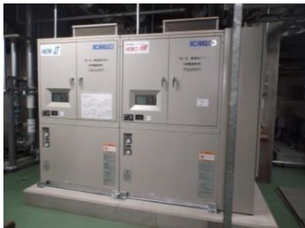
排熱回収ヒートポンプチラー
