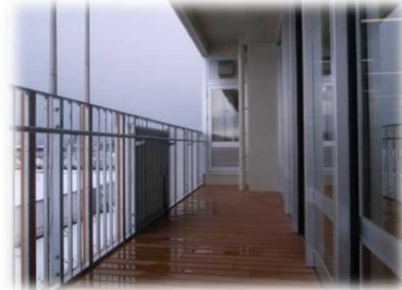
デッキ材等の保護塗料に 柿渋を主原料とした塗料を採用 (柿渋注入処理/二宮農産)
