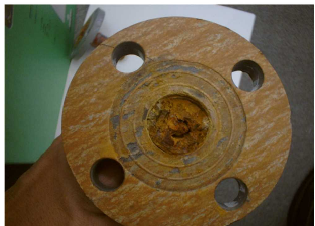
給水管の閉塞状況
