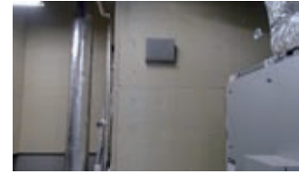
設備室にも非常放送設備を設置し、防災意識を徹底
