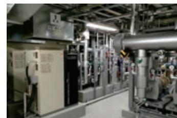
井水利用ヒートポンプ
