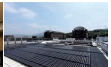
発電量約30kW相当の 太陽光発電設備
