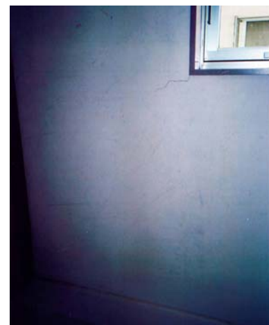
開口部のひび割れ状況 2
