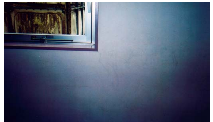
開口部のひび割れ状況 1
