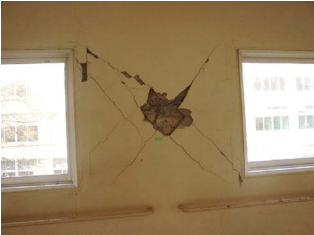
2階短柱のせん断破壊
