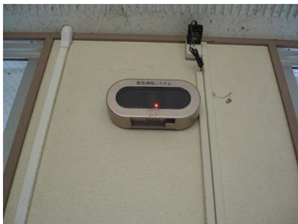
校内に設置されている警報装置
