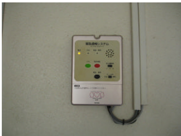
校内に設置されている警報装置
