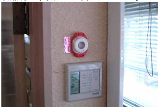
緊急通報装置
