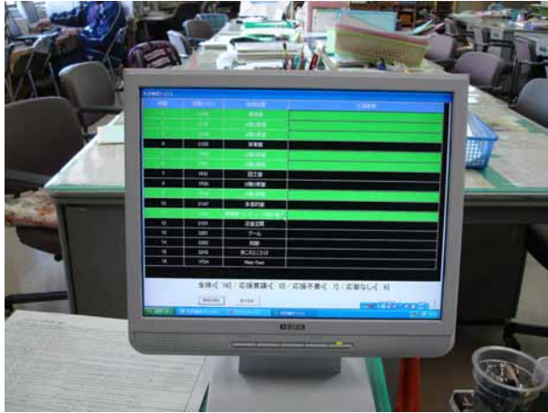
緊急通報システム モニター部
