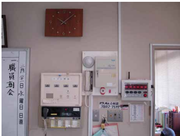
緊急通報システム 表示装置部
