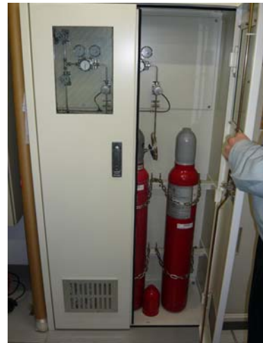
シリンダーキャビネット内の可燃性ガスボンベ。
