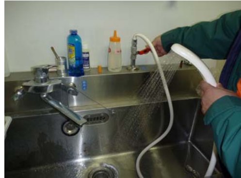
被災内容に応じてシャワー水栓でも対応ができるようになっている。
