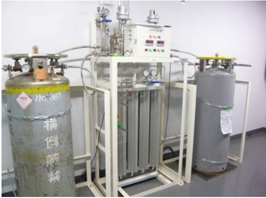
ボンベ庫内で液化アルゴン蒸を蒸発させ、中央配管方式でアルゴンガスを供給している。
