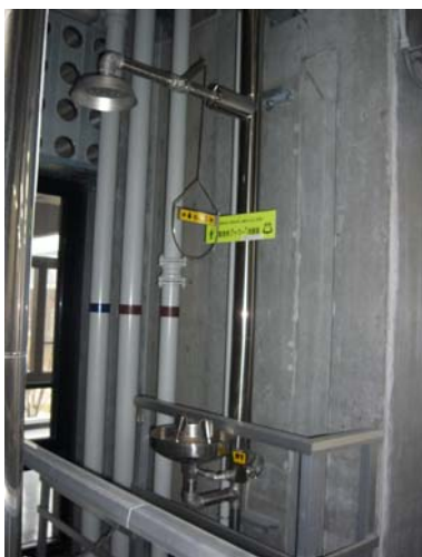
緊急シャワーと洗眼装置を一体的に設けている例。(設置場所については要検討)
