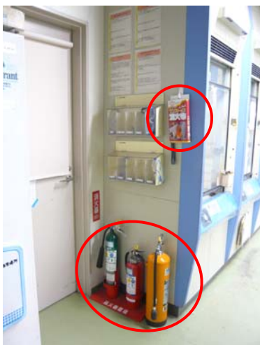
使用する物質に合った消火ができるよう二酸化炭素消火器、粉末消火器、金属火災用消火剤散布器、消火布を設置している。
