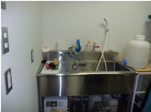
緊急シャワーの他に、流しにシャワー水栓を設けた例。
