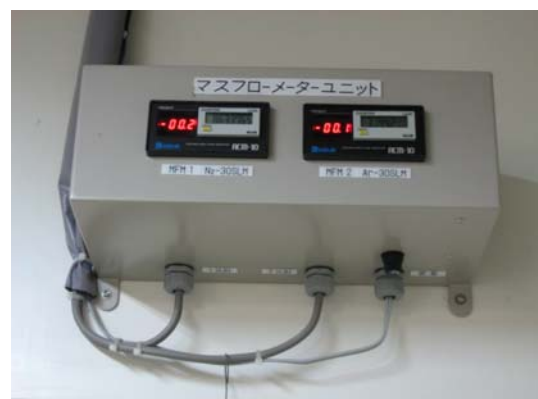
各実験室ごとにガスの計量メーターを設けている。
