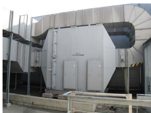
屋上に設置された排ガス処理装置。
