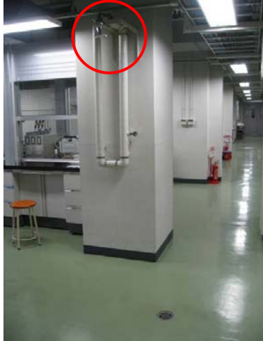
実験室内に設けられた緊急シャワー。
