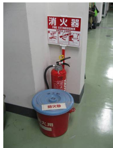
使用する物質に合った消火ができるよう、実験室内に粉末消火器と防火砂を設置している。
