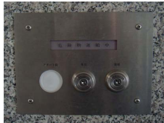
操作盤の拡大写真 鍵により直行運転への切り替えができる。
