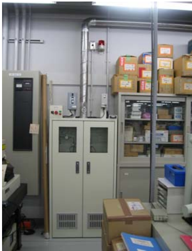
可燃性ガスはシリンダーキャビネット内に設置している。
