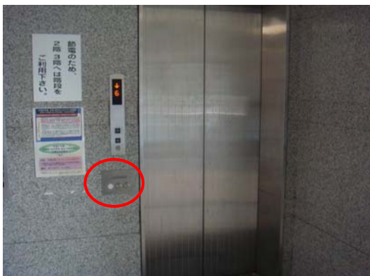
直行運転機能が付いたエレベーター 乗り場の操作盤で直交運転に切り替える。
