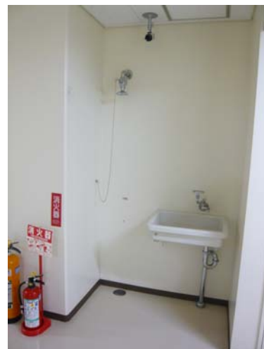
廊下の一部に緊急シャワーと洗眼装置を設けている。
