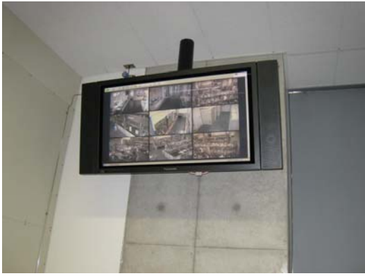
執務室からウェブカメラで実験室内をモニターできる。
