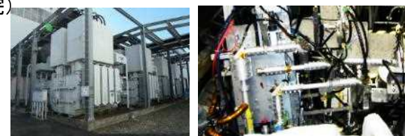
③電源機器(左)及び加熱機器(右)(JT-60)
