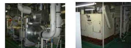
⑤重粒子線がん治療施設HIMACの空調設備
