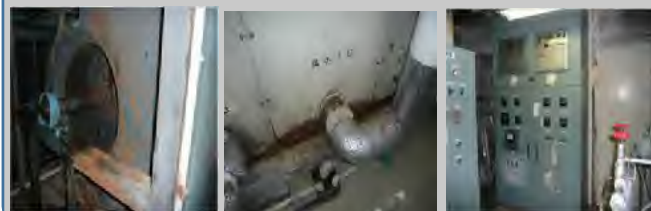
空調機内部劣化
