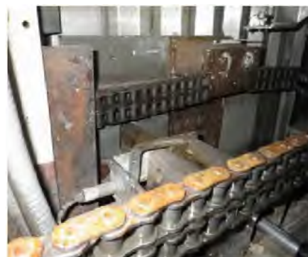
ドームメインシャッター駆動系の老朽化・歪みで誤作動が発生、駆動系の調査・改修が必要
