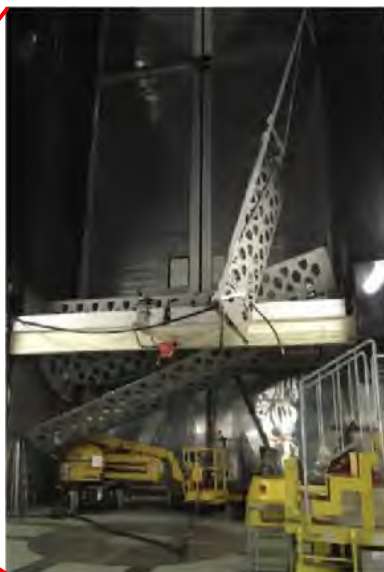
故障によりドーム前面部から落下したウインドスクリーン
