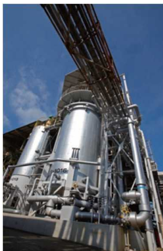
カネカ高砂工業所にある*PHB Hの実証設備
