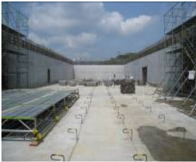
アンジュレータ収納部下流部
