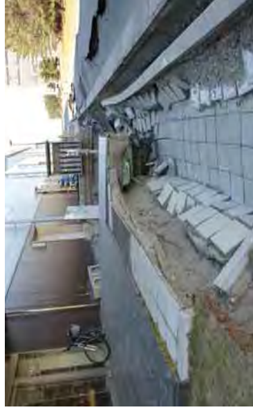
施設周りが1m以上陥没 道路は数十cm盛り上がり
