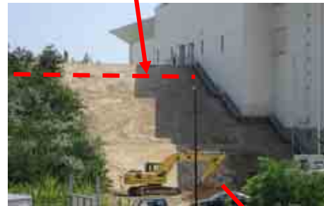
トンネル上部の土盛が約70cm沈下、修復
