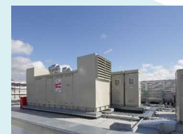
屋上に設置した自家発電設備
