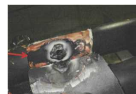
特別高圧ケーブル故障
