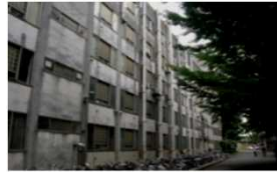
外壁の落下の危険
