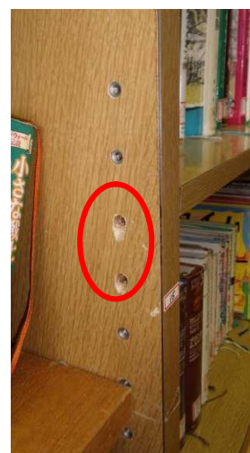
破損した書架のビス穴
