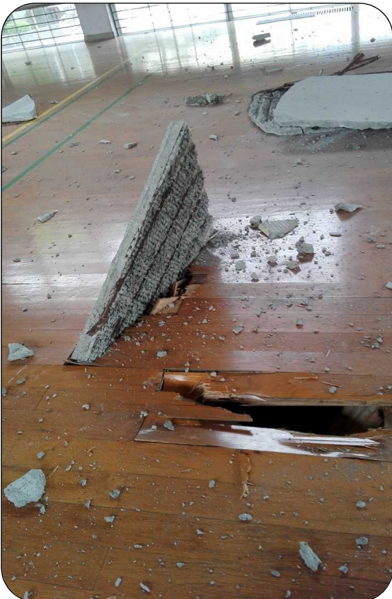
◆体育館内壁落下(東部中)
