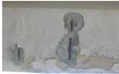
写真1 外壁の鉄筋露出
