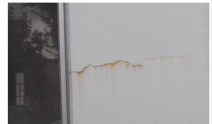
写真2 外壁のひび割れ
