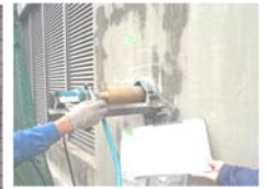
コア強度試験による コンクリート強度の確認 (破壊調査)
