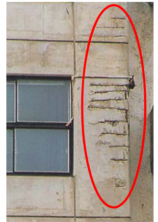
中性化によるひび割れの例 (鉄筋に沿ったひび割れ)
