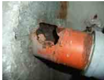
劣化による配管の破損
