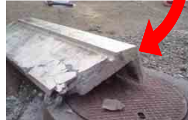
老朽化による手すりの落下
