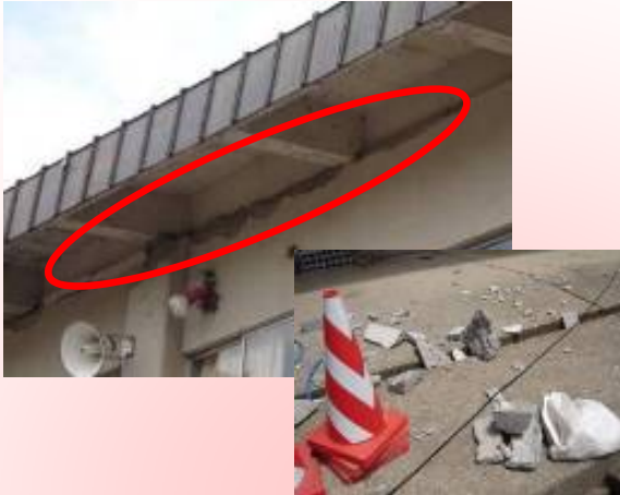
老朽化により コンクリート片が落下
