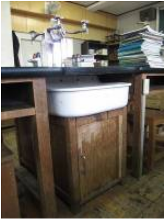
度重なる配管の破損
