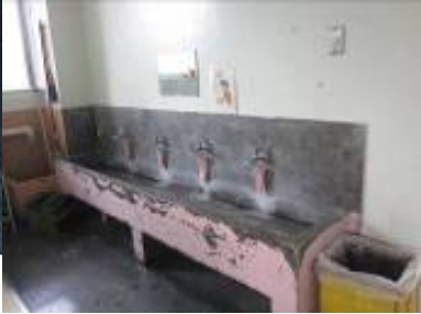
トイレの老朽化による臭気
