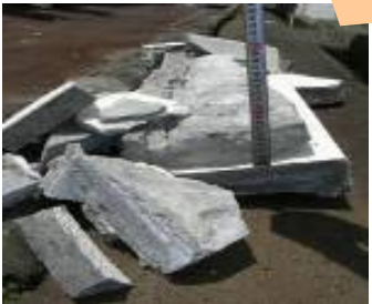
老朽化により モルタルが落下
