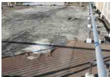
屋上防水の劣化により頻発する雨漏り
