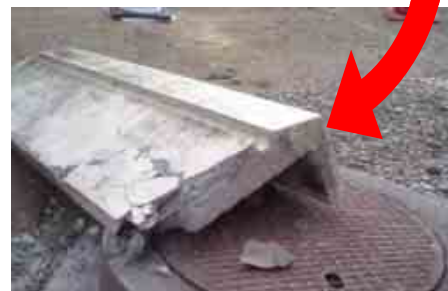
老朽化による手すりの落下
