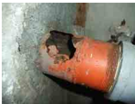
劣化による配管の破損
