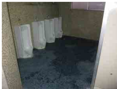
トイレの老朽化による臭気
