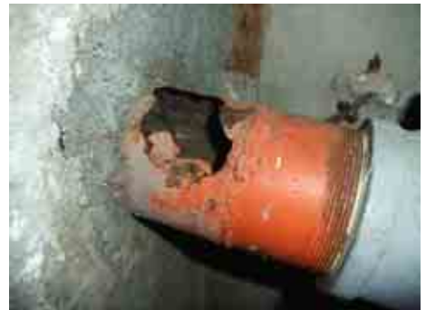
劣化による配管の破損
