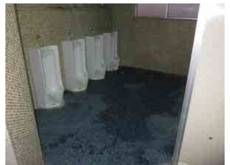
トイレの老朽化による臭気
