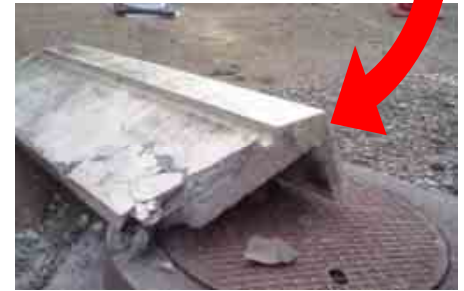
老朽化による手すりの落下
